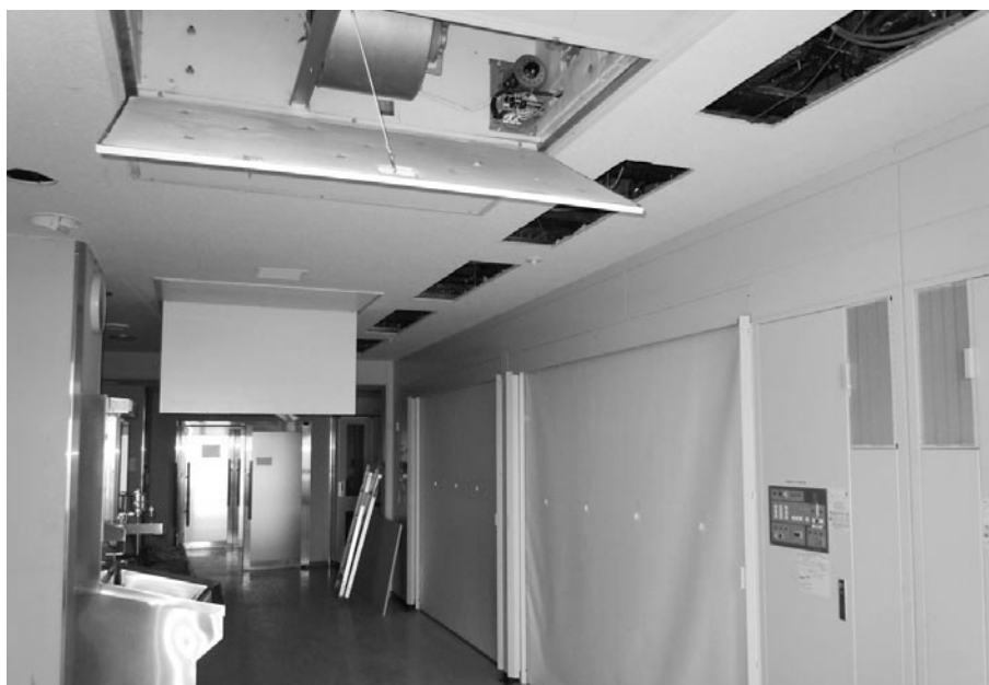
天井から大量の水が……県立がんセンター無菌棟
